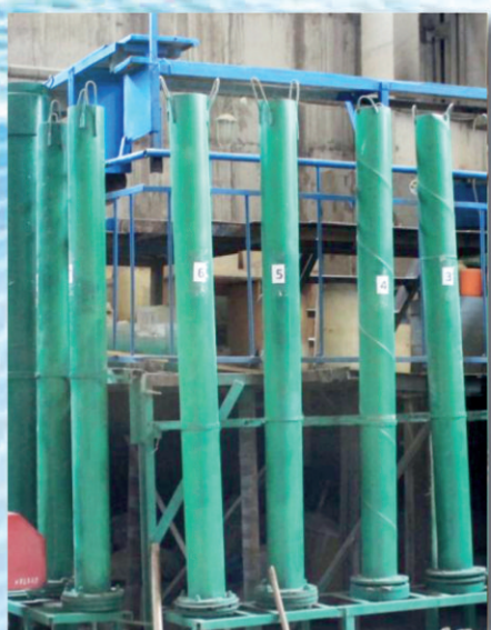
Установка кучного выщелачивания Казмеханобра
