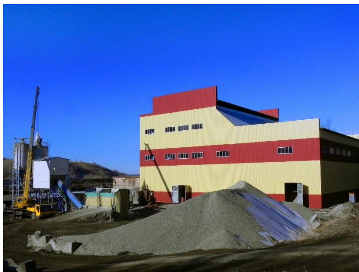
Рисунок 3 – Цех для размещения технологического оборудования по производству ферросплавов
